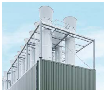
Lüftung, Heizung, Kühlung
